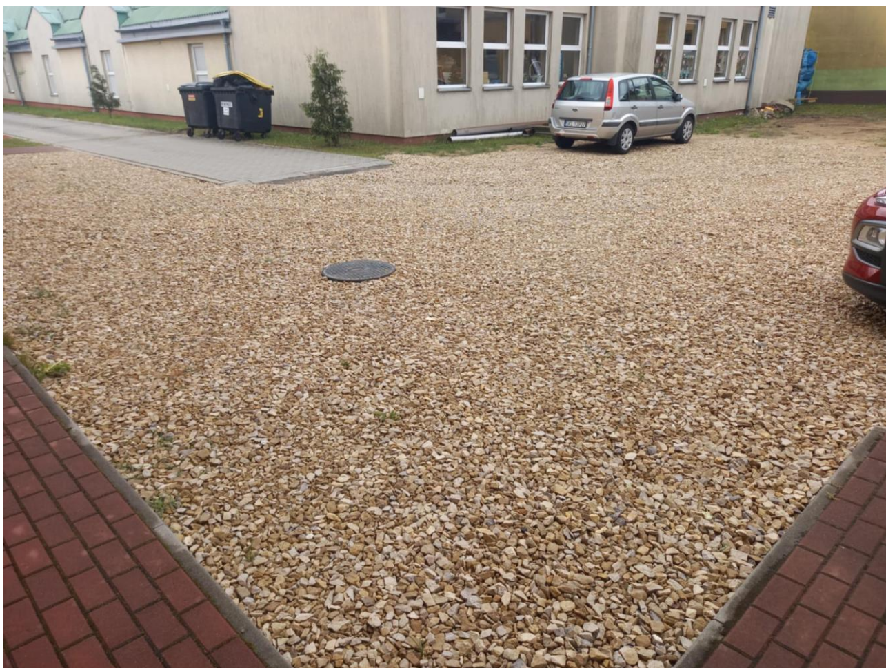
Zdjęcie 7 Odwodnienie na "placu węglowym" Przy ZSP w Ostrowach nad Okszą
